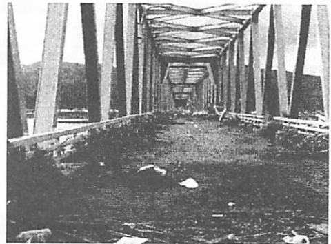
図-18 新北上大橋被災後の桁上状況 12)
