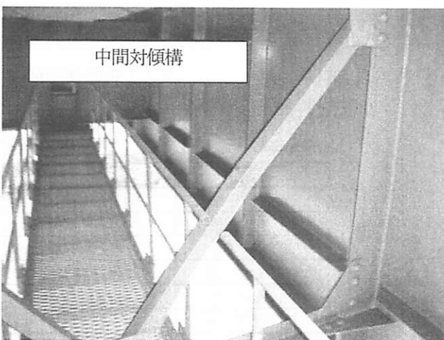
図-1 中間支点上対傾構の座屈
