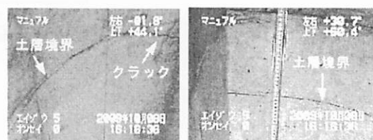
写真-5 ケーソン内部の損傷状況 (+4 \delta_y )
