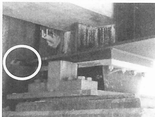
写真-10 G1 桁の桁端部とバラベットの衝突
