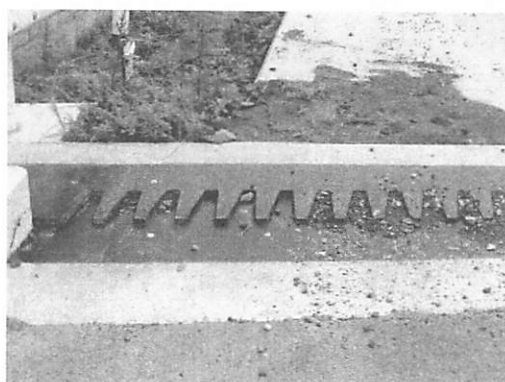
写真-4 A2 橋台のジョイント部の段差
