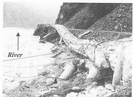
写真-7 爆破されたスパン
