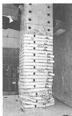
(a) 柱全体の損傷
