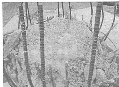
図-13 上部段落し位置の破断面
