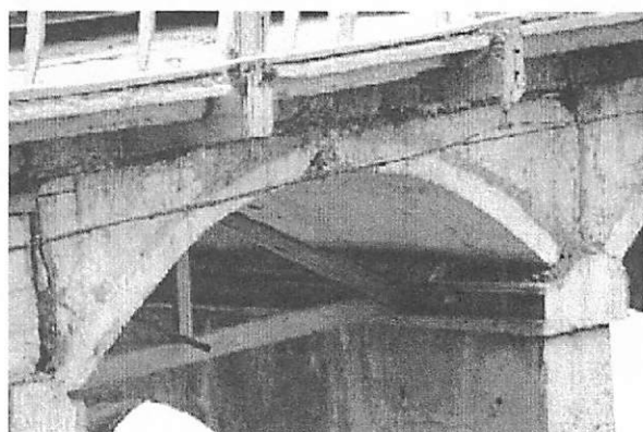
写真-12 アングル材でトラスに応急補強された床版損傷部
