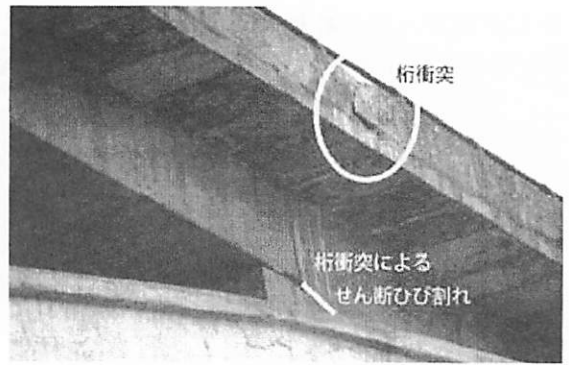
写真-5 アーチクラウン部の桁間衝突
