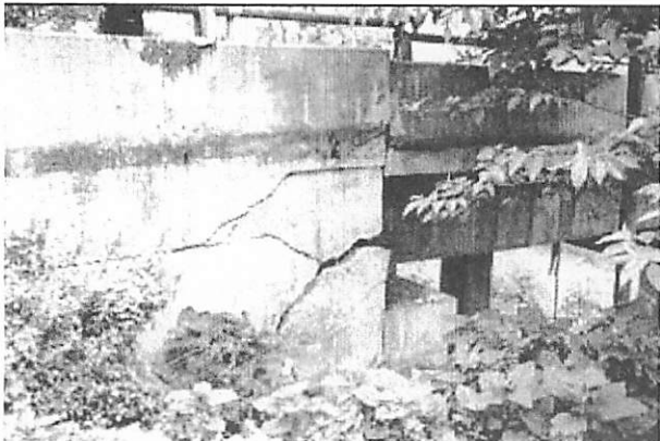
写真-3 主桁の衝突に伴う橋台の被害
