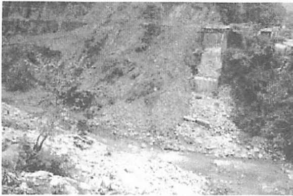
写真-13 倒壊した紅東大橋
