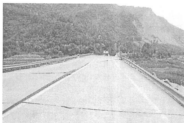
写真-31 A1 橋台裏込め部の破壊 (点 B)
