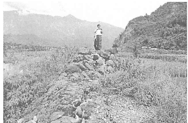
写真-24 左岸の上流側堤防（点A、小魚洞橋から約70m）に生じた段差
