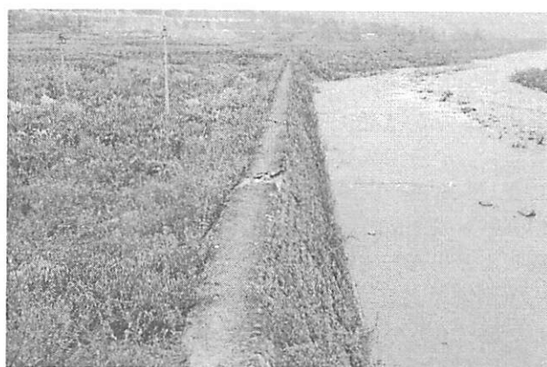
写真-33 上流側から見た右岸上流側の堤防 (点 D, 小魚洞橋から約 50m) に生じた段差
