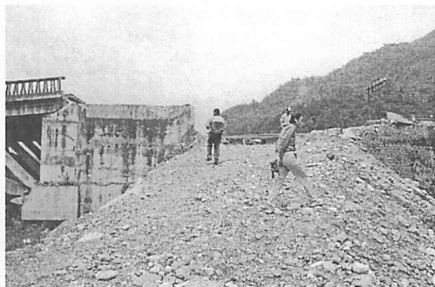
写真-29 A1 橋台裏込め部の破壊（点 B）
