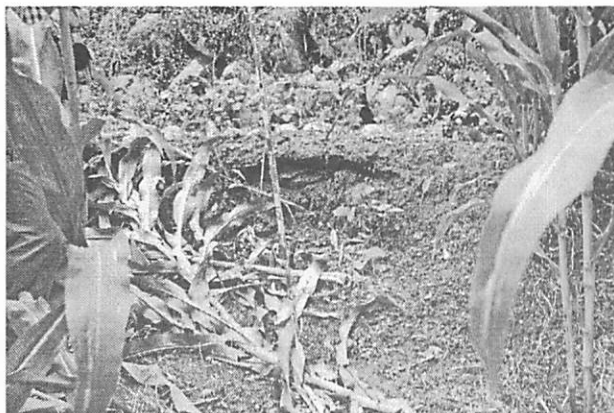
写真-27 護岸基部（堤内地側）に生じた約 0.8m の上下方向段差
