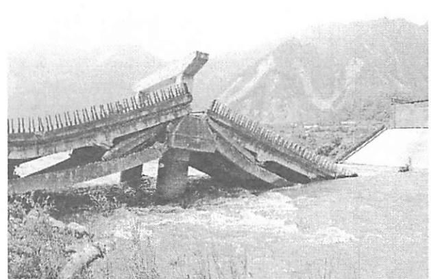
写真-23 A2側に傾斜したP3橋脚とこの頂部から落下した桁3及び桁4（右手はA2）
