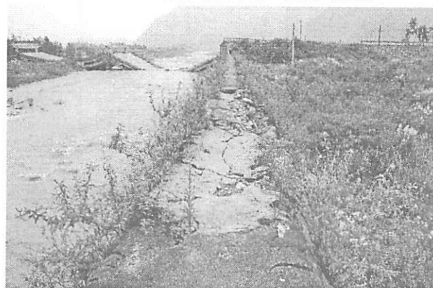
写真-32 上流側から見た右岸上流側の堤防 (点 D, 小魚洞橋から約 50m) に生じた段差
