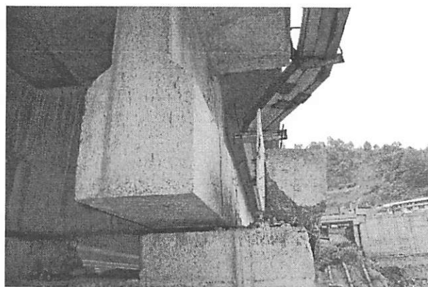
写真-10 サイドブロックの損傷とT桁の移動
