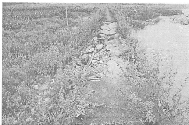
写真-34 右岸上流側の堤防 (点 D, 小魚洞橋から約 50m) に生じた段差のクローズアップ
