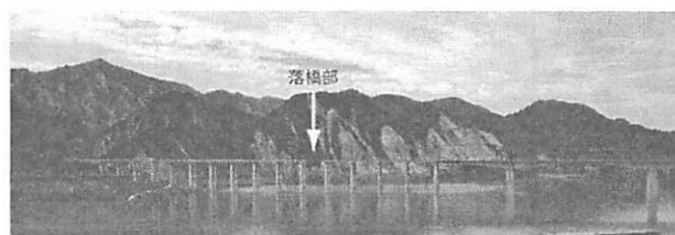
写真-1 廟子坪橋と落橋したスパン
