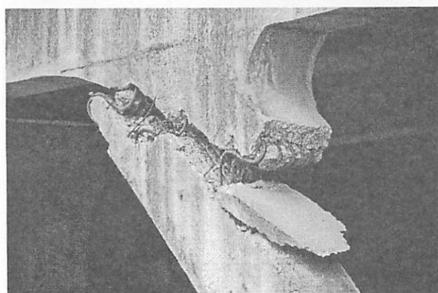
写真-14 桁との接合部に近い斜材の破壊
