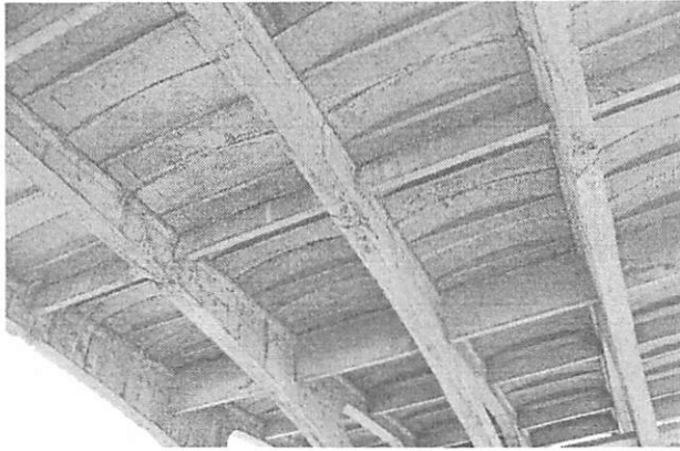
写真-19 縦桁に生じたコンクリートの損傷 (引張及び圧壊)
