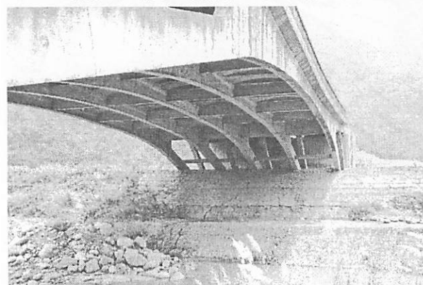
写真-15 桁落下のため護岸（左岸側）に生じたクラック
