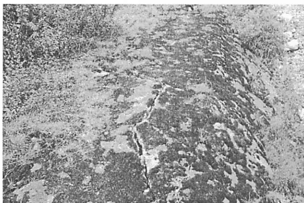
写真-26 護岸のコンクリート被覆に生じたクラック（ほとんど、水平方向の変位はない）
