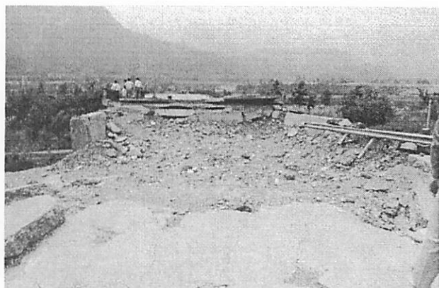
写真-28 A1 橋台裏込め部の破壊（点 B）
