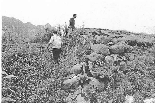
写真-25 堤内地から見た護岸の損傷（写真-24 と同一点）
