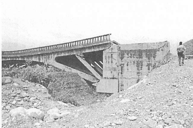
写真-30 A1 橋台裏込め部の破壊（点 B）
