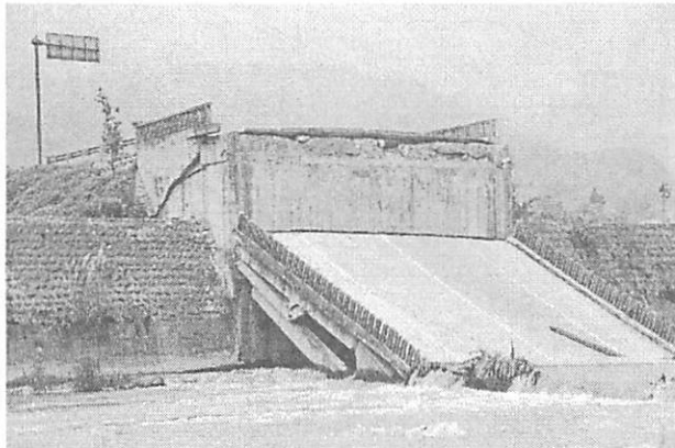
写真-20 A2橋台から落下した桁4（桁が橋台に衝突し、橋台が裏込め側に押し込まれた結果、橋台側面の擁壁がせん断破壊している）
