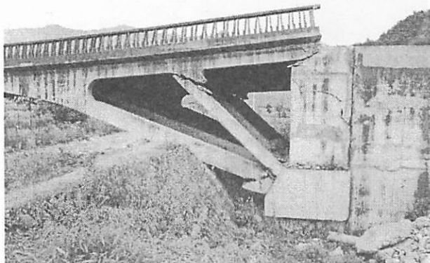
写真-13 A2部におけるラーメン脚及び斜材の被害
