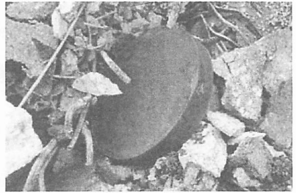
写真-3 落下したゴム支承
