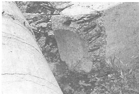
写真-7 橋脚と横梁接合部の分離（P5 橋脚）
