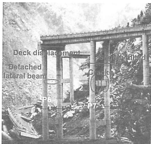
写真-5 P6, P7 橋脚の損傷と桁移動（ネット写真（西南交通大学教授李亞東氏提供）に加筆）
