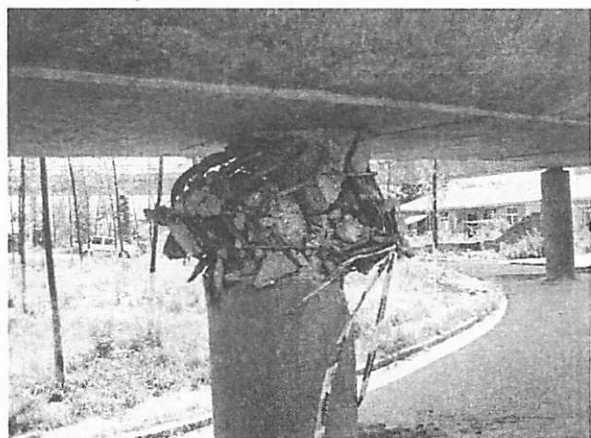
写真-11 P2 橋脚の被害と P3 橋脚
