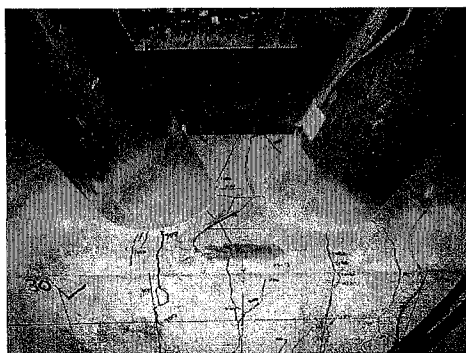
写真-3 格点部の損傷状況
