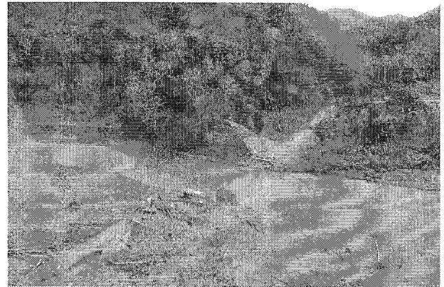
写真-2 橋梁 No.9 の損傷状況(トラス桁の流失)
