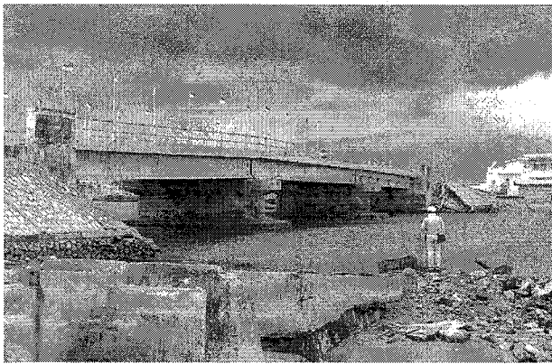
写真-1 橋梁 No.1 の損傷状況(桁移動, 高欄損傷)
