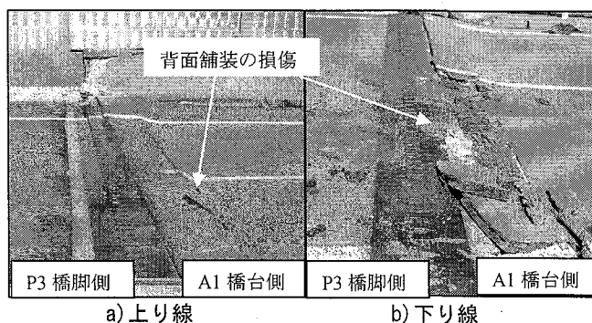
写真-2 A1 橋台上の伸縮装置の損傷状況
