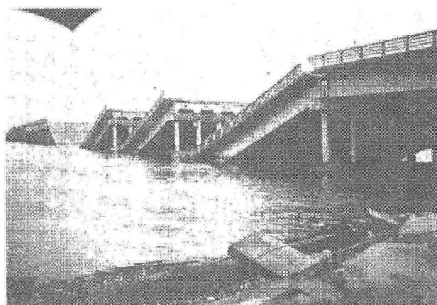
(b) 昭和大橋の被災事例
