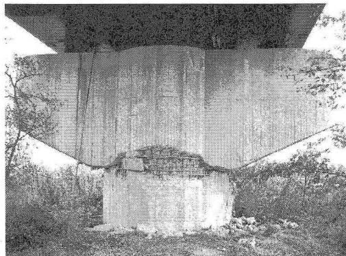
写真-3 小千谷大橋 P2 橋脚の損傷状況
