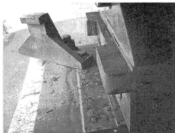
写真-4 小千谷大橋可動支承のサイドブロック損傷
