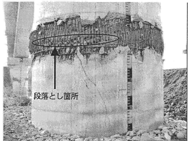
写真-2 上越新幹線魚野川橋梁の橋脚の損傷 (2) (2004年11月6日)
