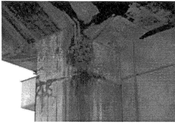
写真-5 第二和南津 R2 高架橋の損傷部
