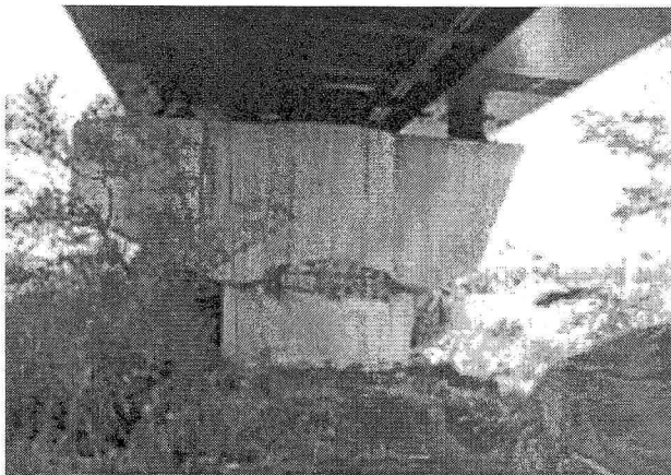
写真-14 P2 固定支承橋脚の被害状況
