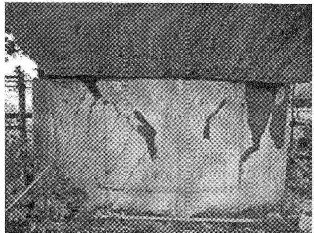
写真-16 橋軸方向面の斜めひび割れ
