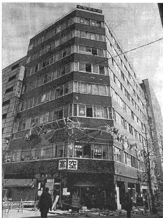
図-24 被害写真（北西角） 7)
