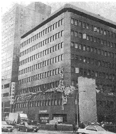
図-8 被害写真（北東角） 7)
