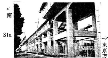
図7 下食満高架橋の変状 5)18)
