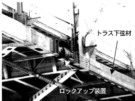
図-7 Carquinez 橋のロックアップ装置
