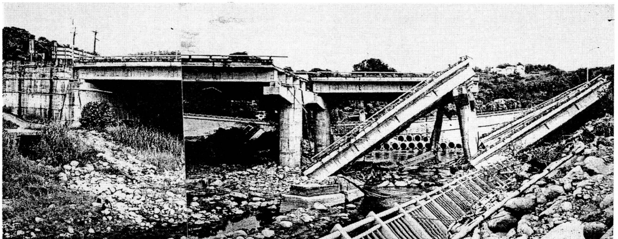
写真-1 石圍橋の被害状況
