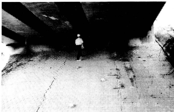
写真-12 No.4橋梁の損傷状況
