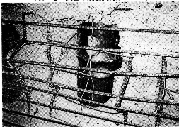
写真－2 鋼管の破壊状況(ケース 8)
