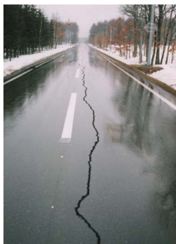
写真-1 凍上による縦断クラック
