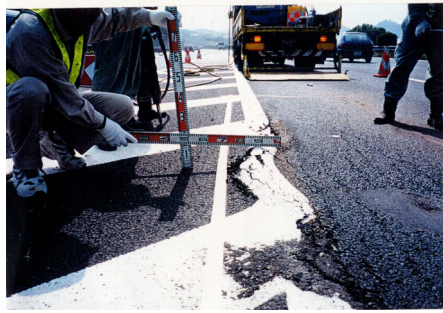
写真-1 高機能舗装の局部流動の例
