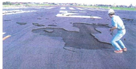
写真-1 2000年7月の名古屋空港滑走路の破損
