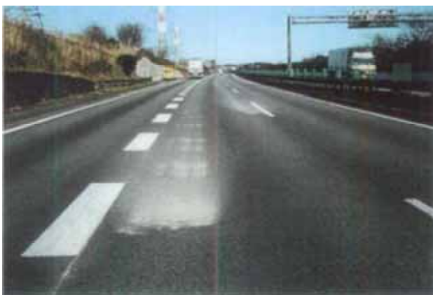
写真-1 ポンピングの発生事例
