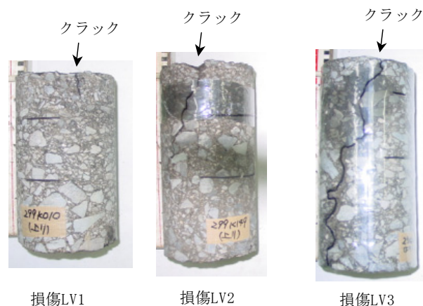
図-8 損傷レベルと舗装の採取コアの状態
