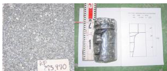
写真-4 ⑧高機能舗装のクラック
