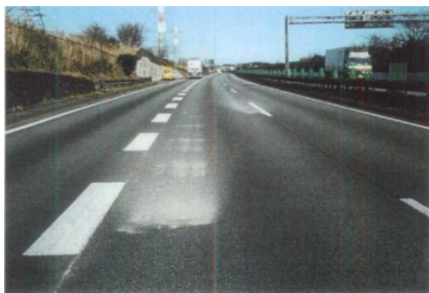
写真-1 ポンピングの発生事例
