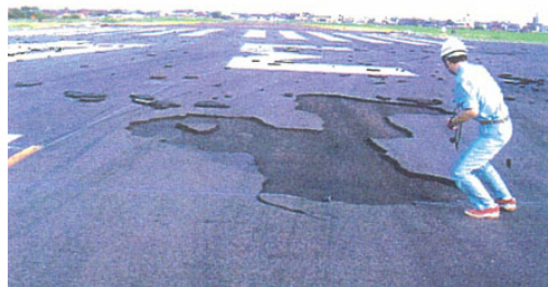
写真-1 名古屋空港滑走路の損傷
