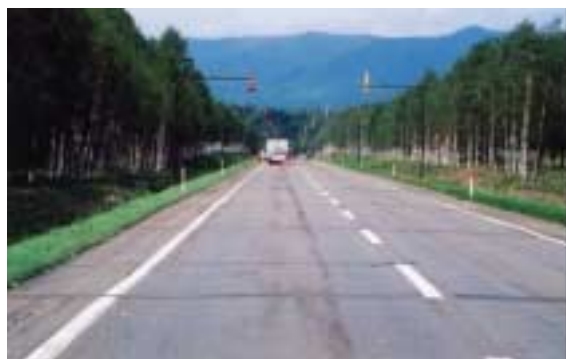
写真-2 低温クラック発生状況 (補修後)
