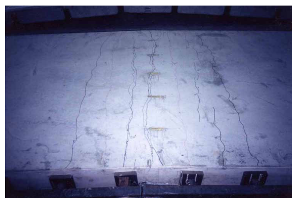
写真－6 PCC 版ひび割れ発生状況
