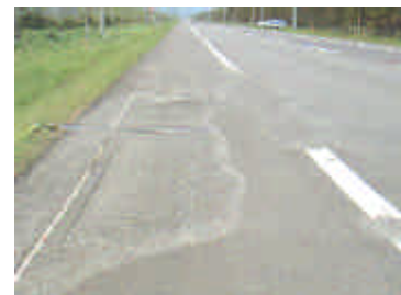
写真-5 セミホット混合物工区の舗装のはがれ
