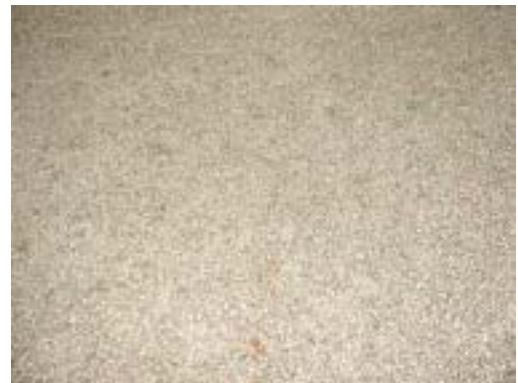
写真-7 樹脂舗装の舗装表面 (区間)
