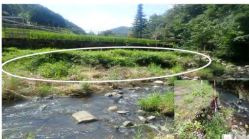
図-4 石積崩壊 B
