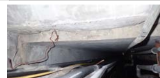
写真-4 ケーブルダクト
