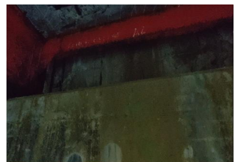
図-2 照度不足の画像
