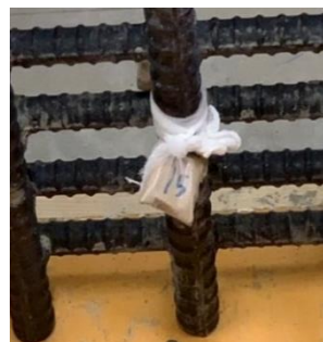
写真—3 無線 IC タグ設置方法
