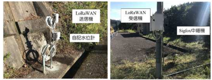
図 3 機器設置状況
