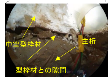
写真-2 主桁内部の空隙
