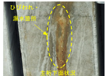
写真-1 桁下面損傷状況
