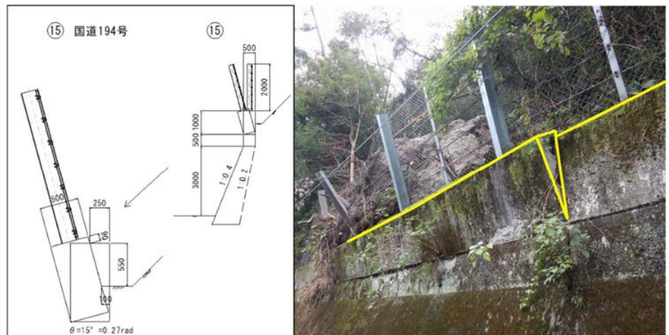
図 3 落石防護柵基礎擁壁の変状
