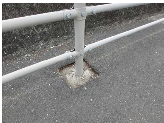
図-1 転落防止柵の基礎が沈下
