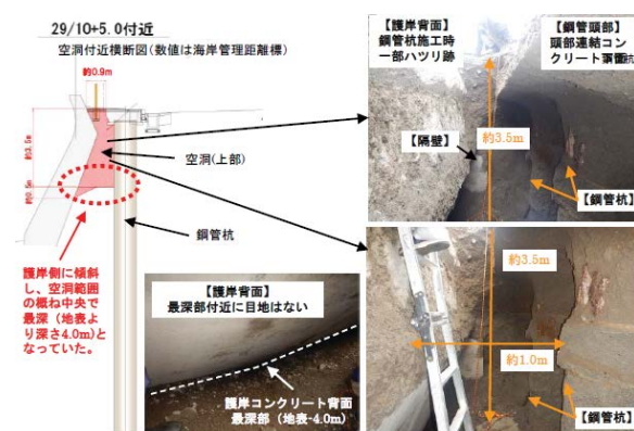
図-2 確認された空洞（上部）の状況
