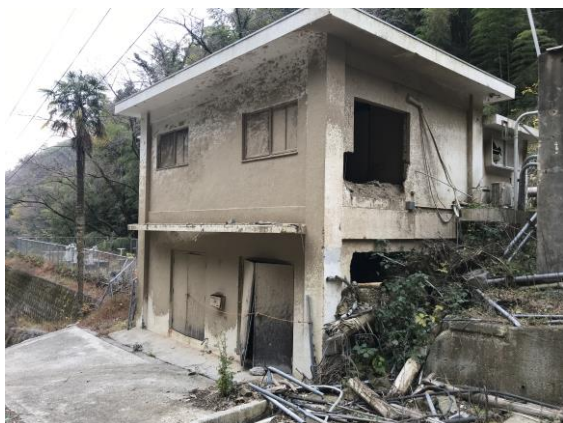
写真-1 土砂災害により被災した吉田浄水場
