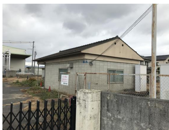
写真-2 浸水により被災した真備浄水場
