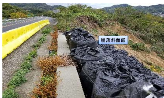
図-1 法面崩落箇所
