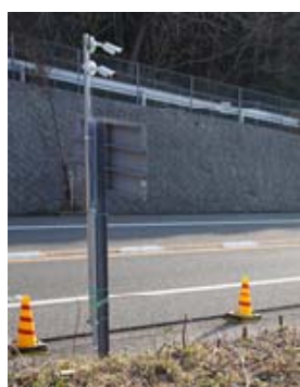
図-4 カメラ設置状況
