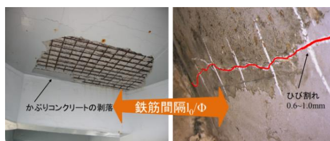
(a) 水平ひび割れ (b) 鉄筋に沿ったひび割れ
