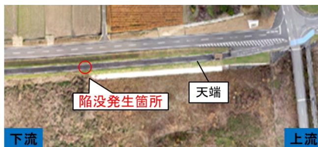
図 3 重信川右岸 15.8k 地点の陥没箇所
