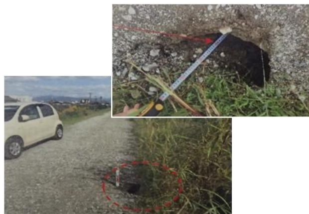
図 1 小段上の陥没孔 (2017/9 松山河川国道事務所)
