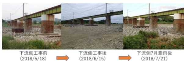
図-4 土器川における橋梁周辺の河床変化
