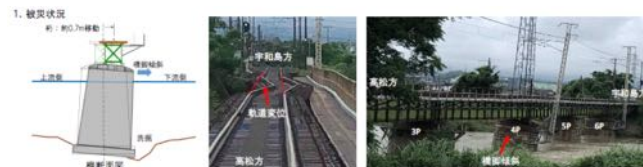
図-6 財田川橋梁の被災状況（提供：JR 四国）
