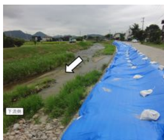
図-5 金倉川における河岸浸食（2018 年 8 月 9 日）
