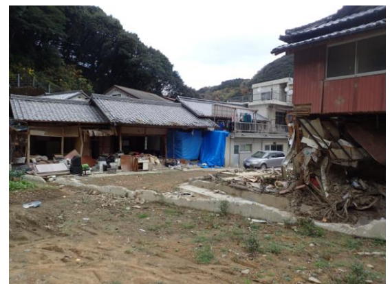
写真2 南君地区の家屋の被災状況（12月8日撮影、避難中の家族3名が犠牲になった。）
