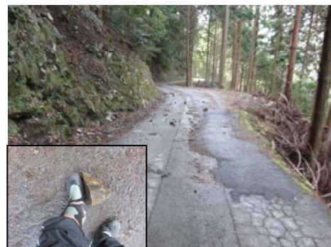
写真-1 小規模落石の状況
