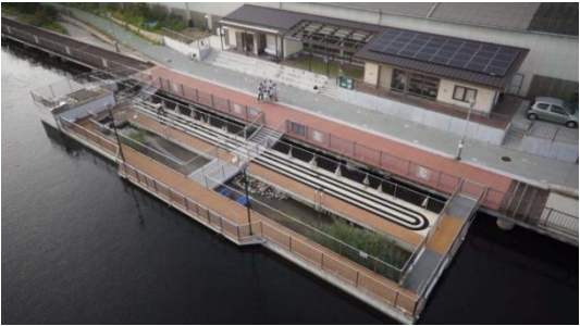
写真 1 尼崎運河水質浄化施設
